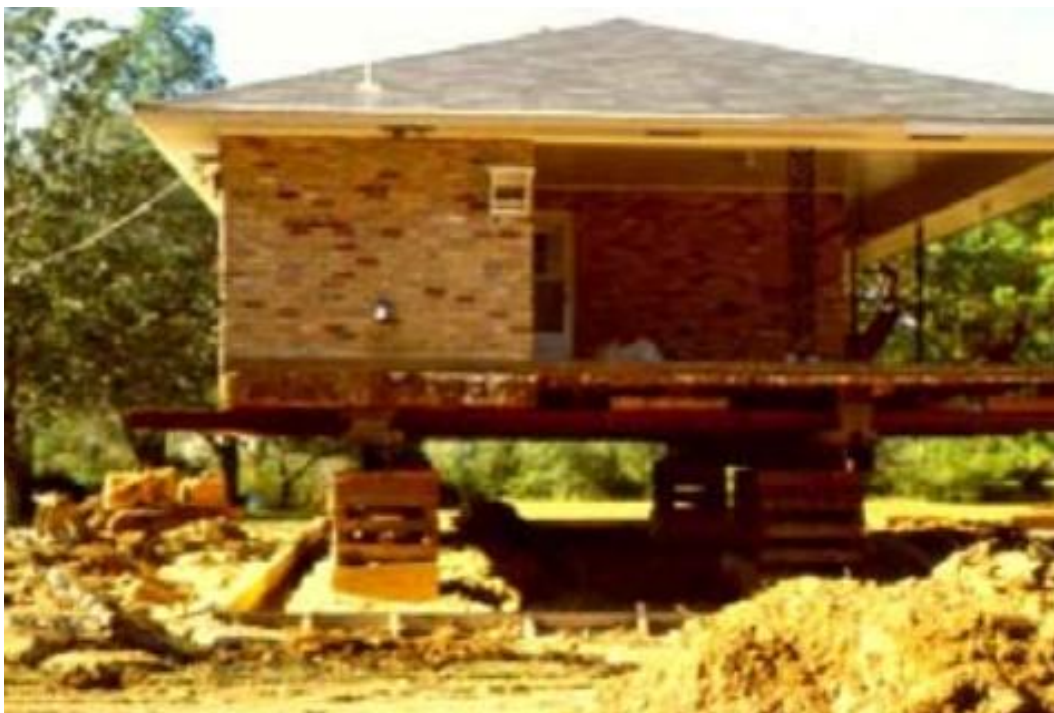
Figura 2.6 – Exemplo da elevação de uma habitação. Nesta imagem é apresentada uma habitação cujos pedestais, entre as fundações e a edificação, foram aumentados, de forma a superar o nível atingido pela cheia de projecto (HAN, et al. , 2002).
