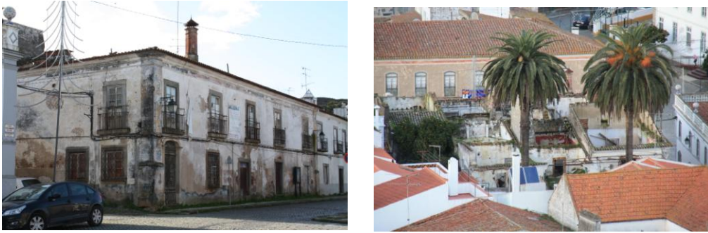
Figura 39 - Edifício em ruínas no Largo General Humberto Delgado, Montemor-o-Novo
