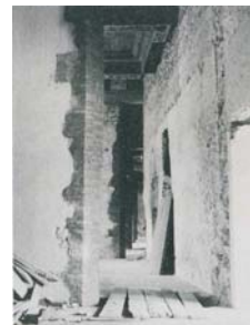
45. O corredor da Galleria dei Dipinti , no primeiro piso da ala della Galleria , durante a intervenção de restauro.
