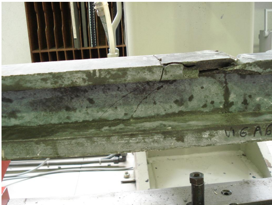
Figura 4.57: Pormenor da zona rotura da Viga 6
