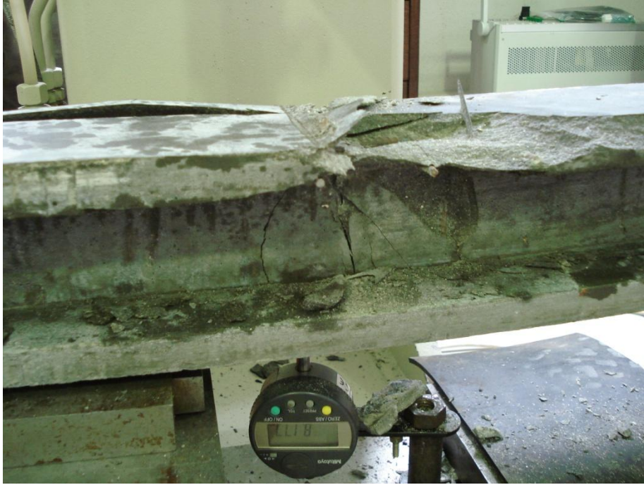
Figura 4.39: Pormenor da zona rotura da Viga 3
