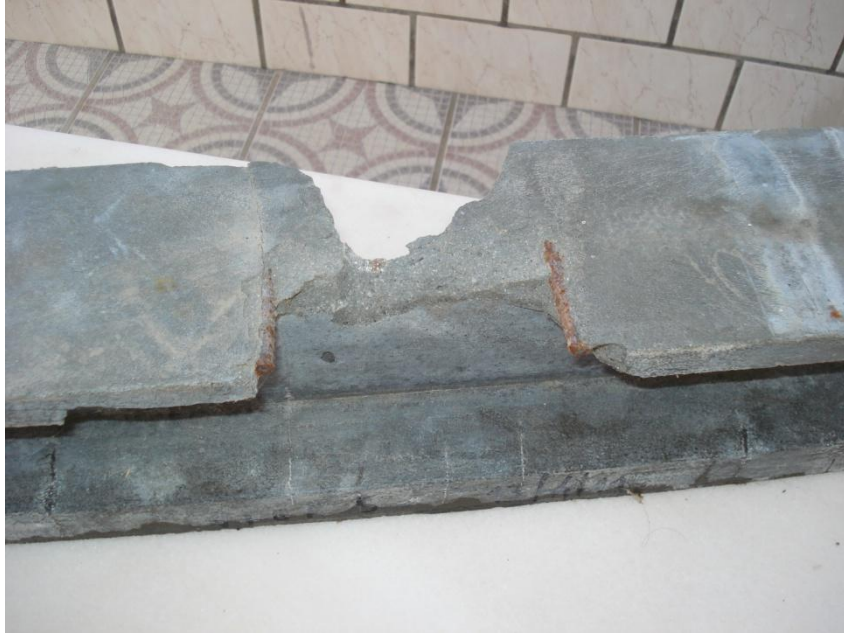
Figura 4.54: Pormenor da zona de rotura da Viga 5
