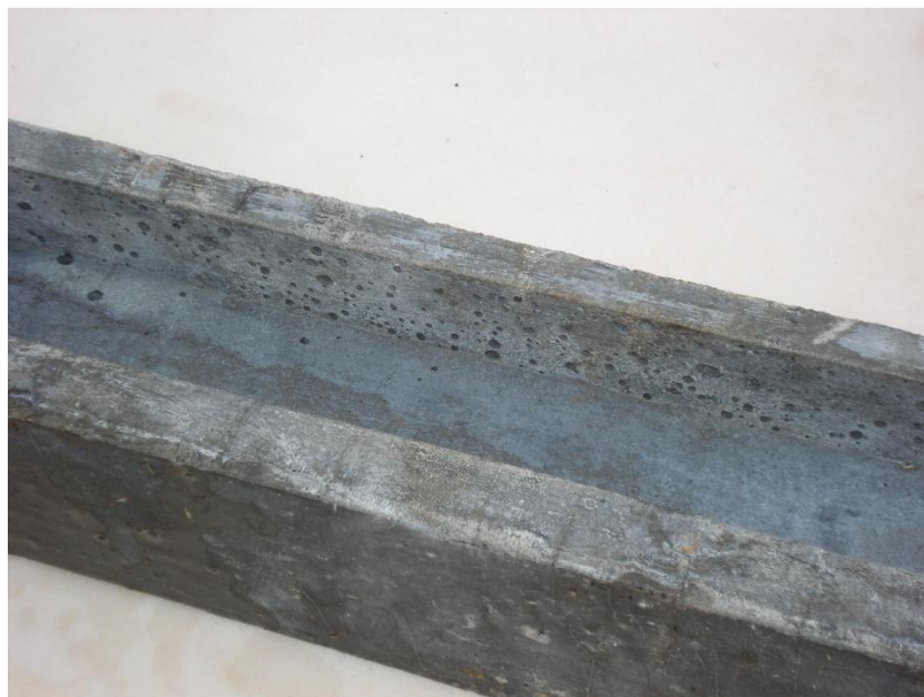
Figura 4.55: Poros na parte inferior do banzo superior (Viga 5 e Viga 6)
