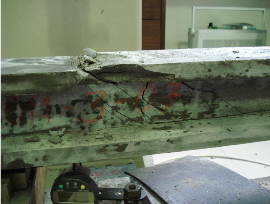
Figura 4.45: Pormenor da zona rotura da Viga 4
