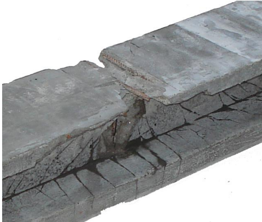
Figura 4.66: Pormenor da zona rotura da Viga 7
