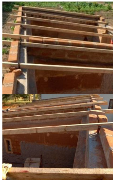
Figura 101- Barros de madeira da cobertura e assentamento destes. fixados com peças metálicas chumbadas.
