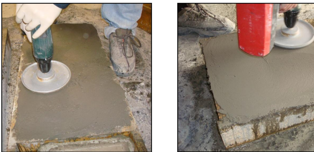
Figura 19 – Afagamento das lajetas.
