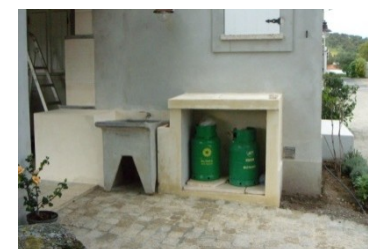
Fig. 32 – Vista sobre as instalações do gás e do tanque atual
