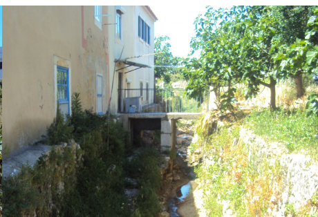
FIG. 79 - VISÍVEL ESTRANGULAMENTO DO LEITO
