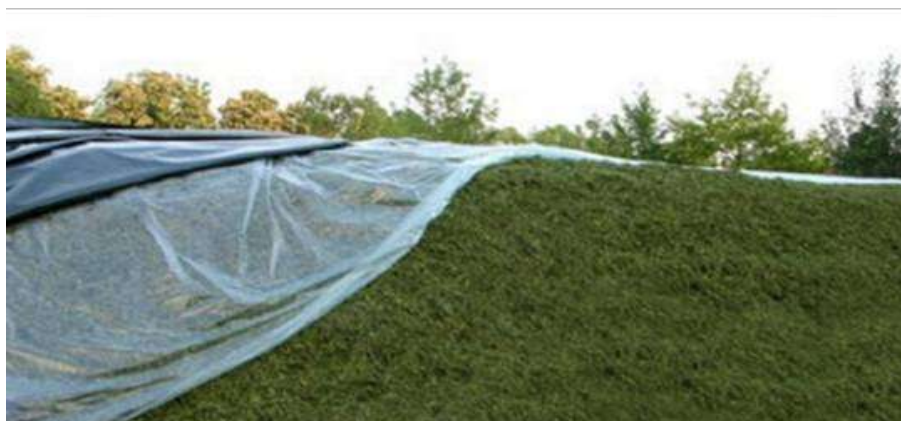
Fig.6 – O fecho do silo vai impedir a actividade da flora aeróbia
