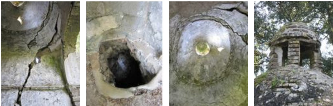
Figs. 31, 32, 33, 34, 35, 36 e 37 – Vistas do exterior e interior da Fonte da Quinta do Arcediago e do deplorável estado de conservação em que se encontra.
