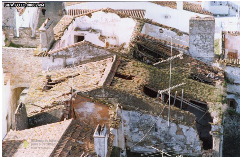
Fig.3 Telhado em ruína da Casa Alcaide-mor de Estremoz, 1993 ©SIPA
