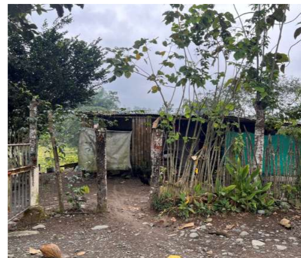
93. Vivienda en malas condiciones, Santo Domingo Fuente: La autora
