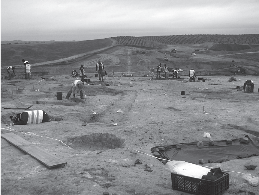
Imagem 3 – Torre Velha 3, Serpa. Decapagens mecânicas no âmbito do acompanhamento e escavação arqueológica em área em fase de construção da barragem da Laje
