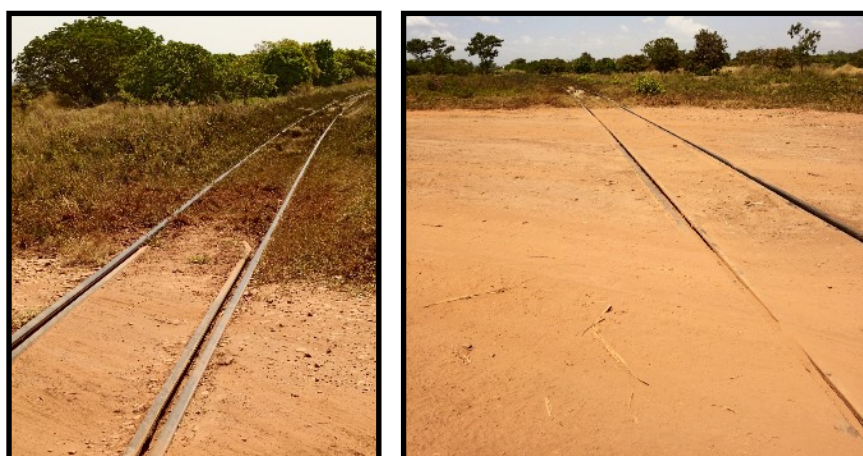
Figure 26 : Photographies des rails abandonnés dans le périmètre sucrier de la SN SOSUCO
