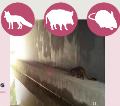
Passadiços em passagem hidráulica
