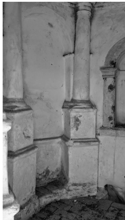
Fig. 329. Aspeto interior, em mau estado. Fotografia de Carlos Lopes, 2012.
