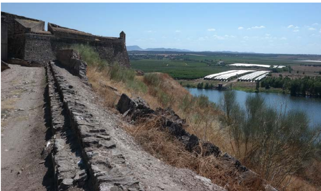
Fotografia 12 Muralha rota e caída na zona direita de entrada na fortificação
