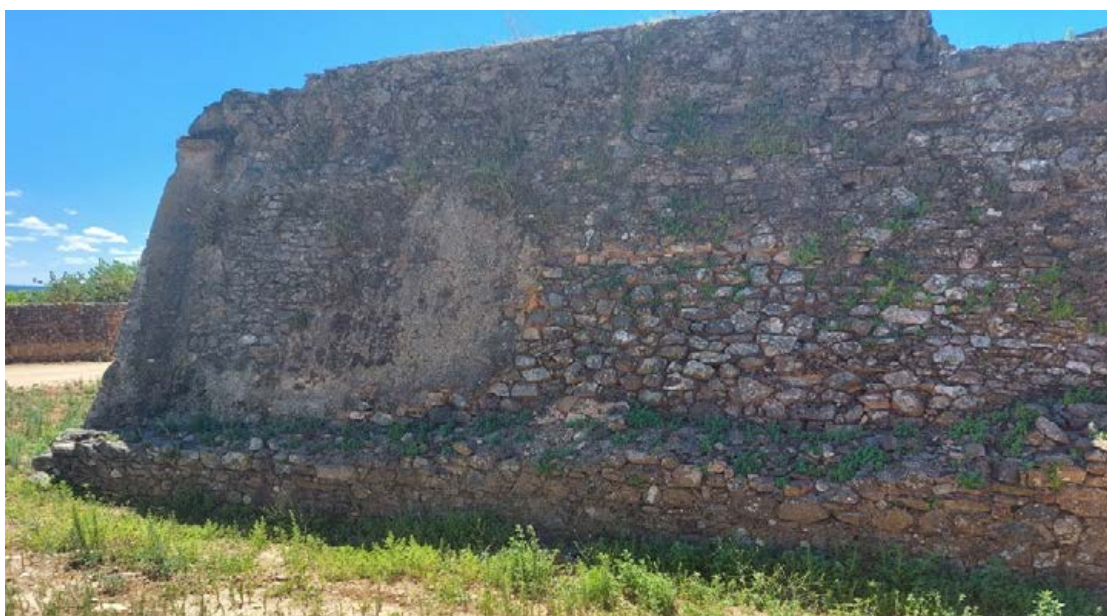
Fotografia 12 Pano de cortina de baluarte desgastado
