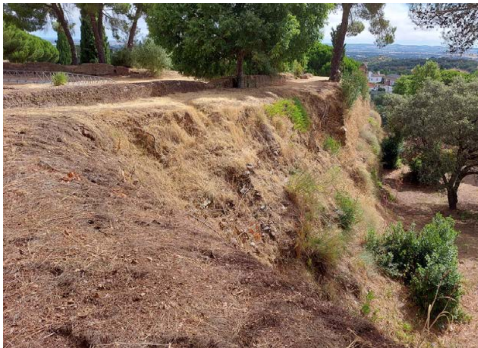
Fotografia 16 Pano de muralha aterrado respeitante ao baluarte do lado esquerdo da fortificação
