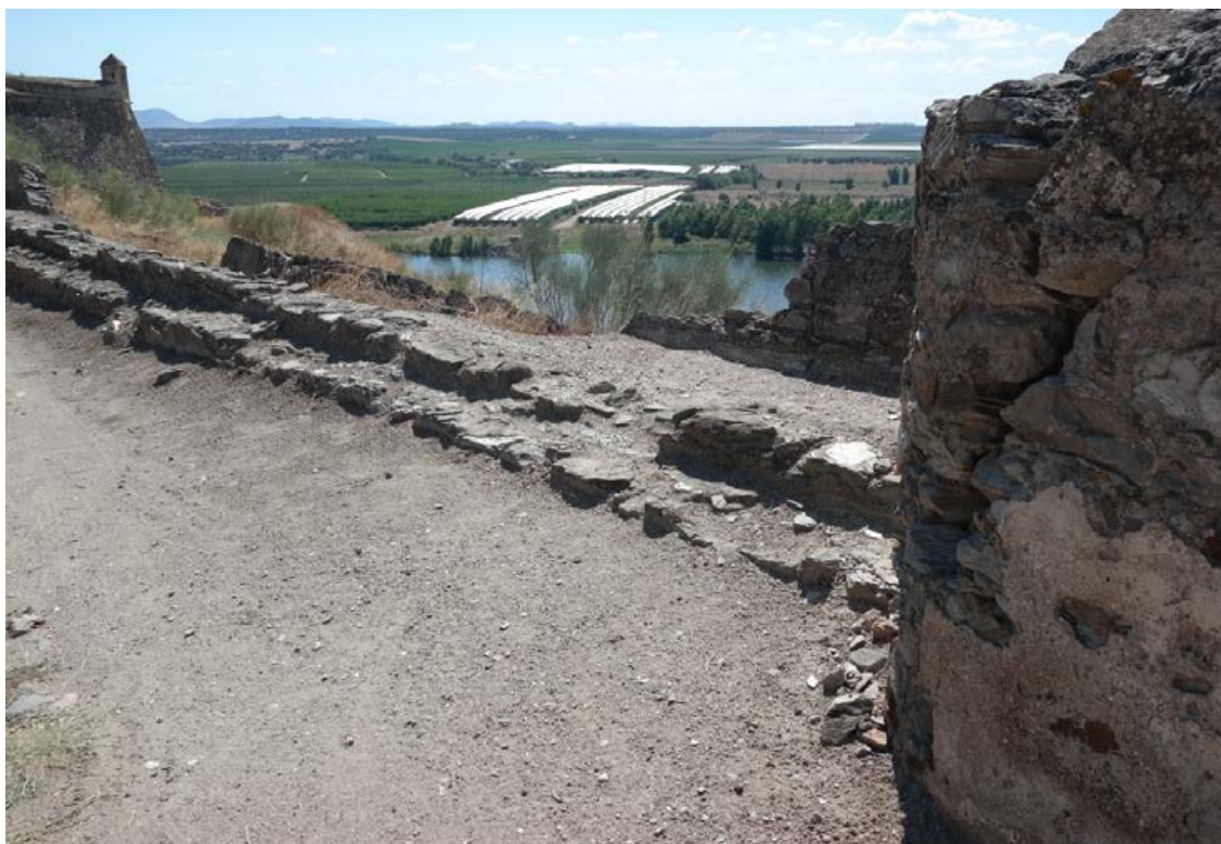
Fotografia 11 Muralha rota na zona direita de entrada na fortificação
