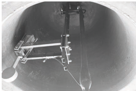
Fig. 17 - Electromazo interior instalado en una de las campanas de la S.I. Catedral de Ávila. Foto del autor.
