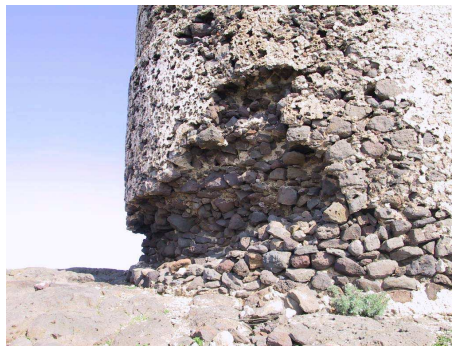
Fig. 15 – Torre di Foghe, erosion at the base
