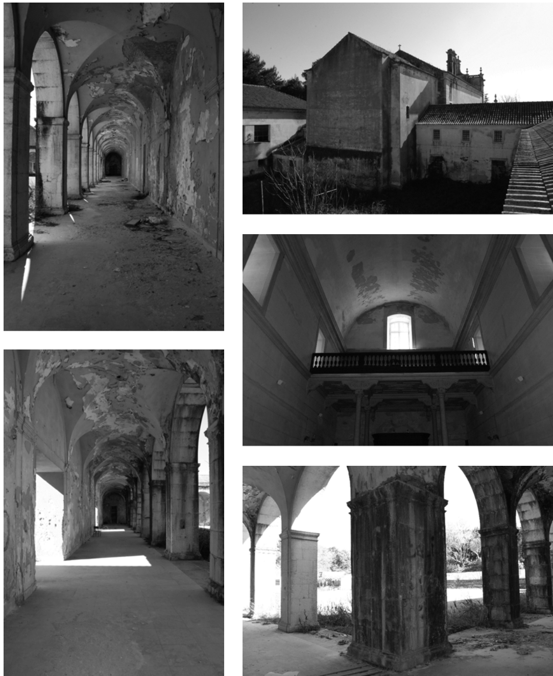
Fig. 120: Degradação das estruturas monásticas restantes (galerias do claustro grande à esquerda e em baixo e igreja à direita).
