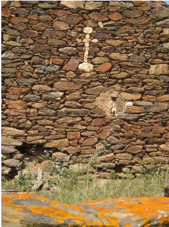
Figura 40 - Muro em alvenaria seca de xisto, em Mosteiro, Mértola (Autor: José M. de Mascarenhas, 2019).
