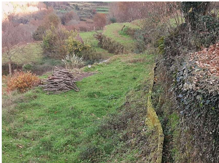
Figura 93 – Aspeto de um canal de rega no Sistelo, em mau estado de conservação, integrado num sistema de socalcos (Autor: FTB, 2019).
