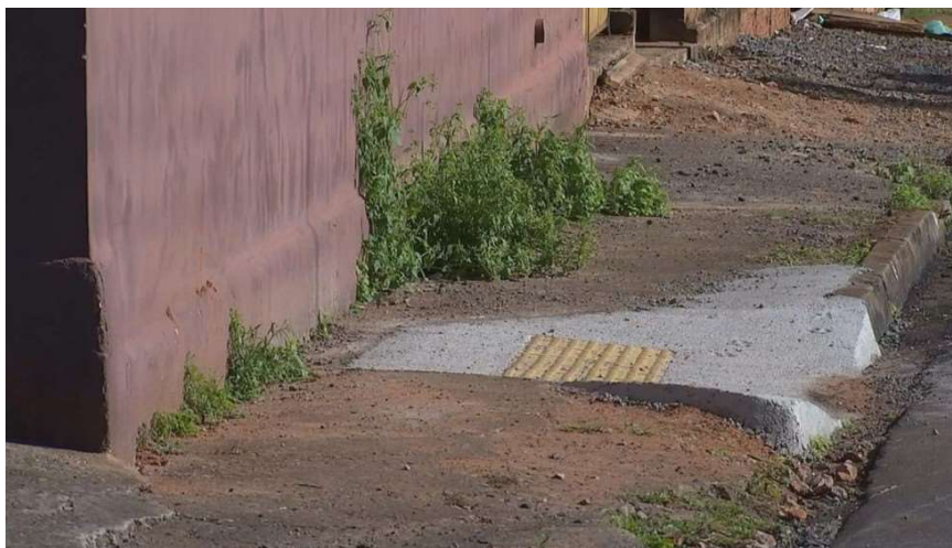
Figura 16 - Exemplo de Rampa, em Capão Bonito (Brasil) que não cria acessibilidade
