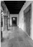
Detalhe da galeria do piso térreo do claustro (junto à igreja, que liga a portaria à casa de profundos [12-08-2007]), Convento de S. Boaventura (Museu das Flores).
