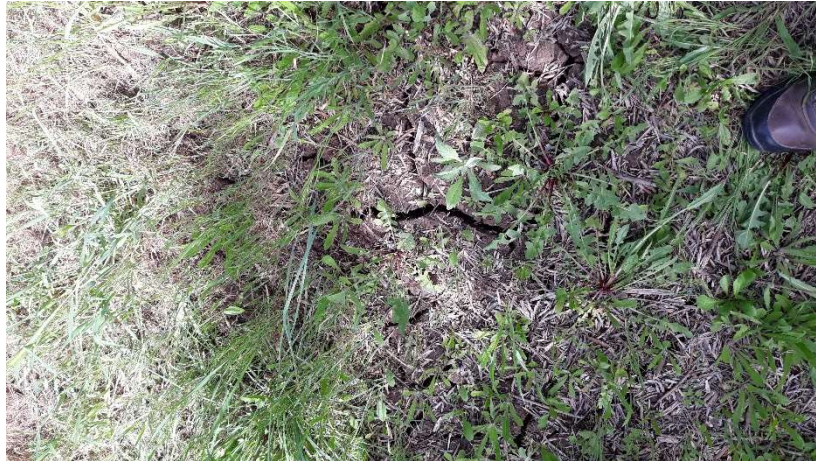
Figura 17 - Exemplo de fendas em solo franco-argiloso; Serpa.
