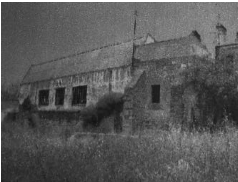
Fig. 50. FOTOGRAFIA DO ANTIGO CONVENTO DE SÃO DOMINGOS , Fachada poente (2004 anterior à intervenção)
