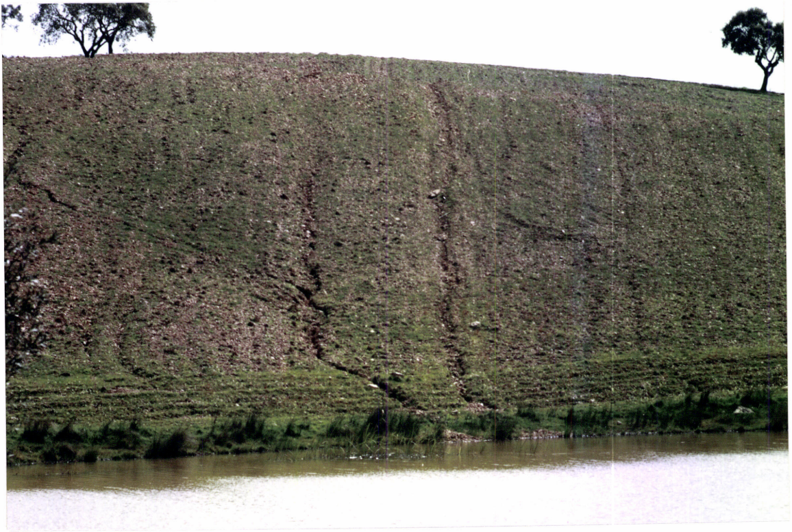
Aspectos dos efeitos da erosão pela escorrência superficial, potenciada pelo facto do solo se encontrar nú.
