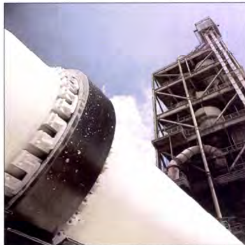
Figura 2: Parte do forno (à esquerda) e da torre de ciclones de pré-aquecimento (à direita) da Cimpor (Coutinho, 2006).
