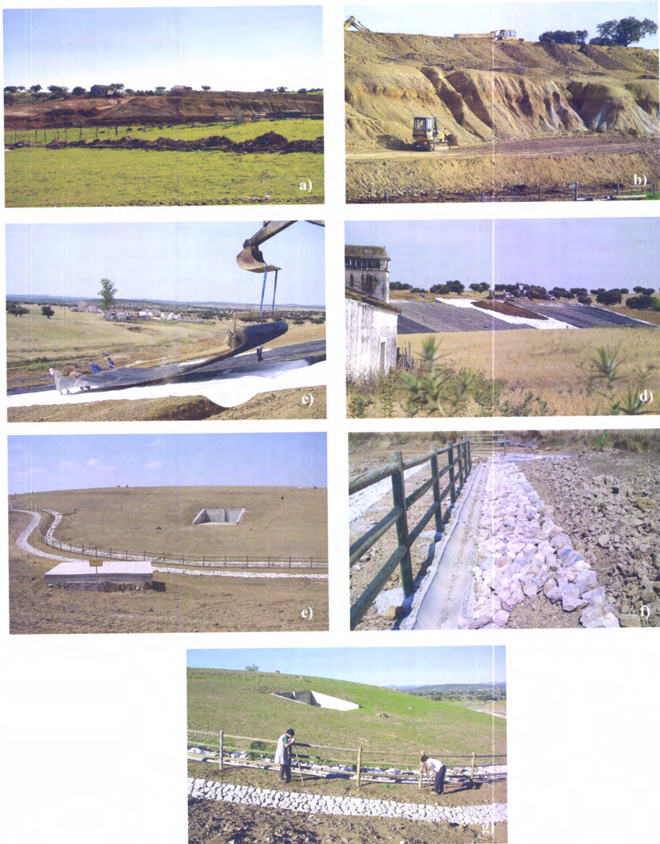
Figura 2.3. Sequência dos trabalhos de remediação realizados pela empresa Conduril (Construtora Duriense, S.A), a pedido do Instituto de Desenvolvimento Rural e Hidráulica (IDRHa). [a] vista parcial da zona mineira antes dos trabalhos de remediação; [b] trabalhos de modelação da
