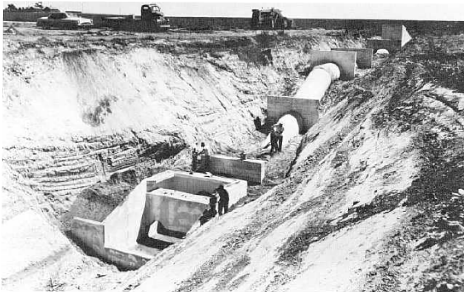
Figura 2.23. Colares corta-águas ao longo de uma conduta em pressão (coincidentes ou não com os maciços de amarração da conduta (USB, 1987).
