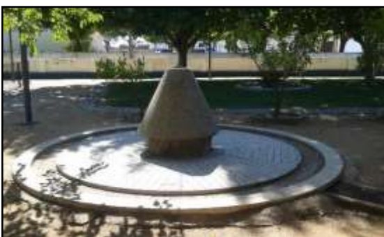
Figura 22 – Elemento de água – Repuxo inativo
