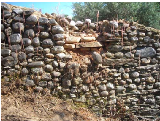
i161. Reparação de um dos quatro pontos da parede que se encontravam danificados, com recurso a barro extraído da charca e a pedras do local. Neste caso, tentou-se replicar a técnica construtiva já existente.
