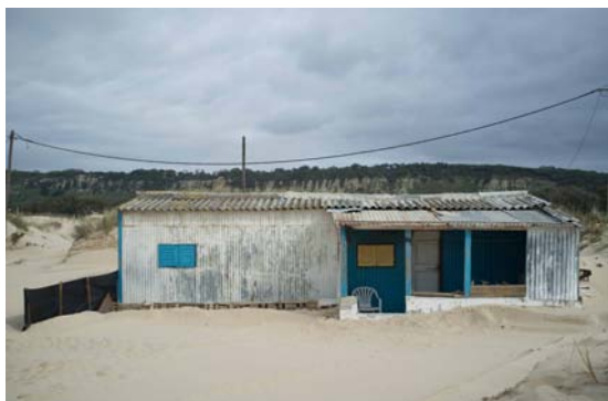
i106. Vernacular contemporâneo atlântico. Costa da Caparica. As coberturas em fibrocimento são de comercialização proibida em Portugal desde 1994 e de aplicação proibida na Comunidade Europeia desde 2005 mas esta mantém-se.
