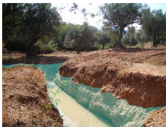
i152. Charca após a retro-escavadora ter encontrado terra rota (Junho de 2013). A azul o nível expectável da água na Primavera de 2014.
