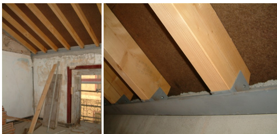
Figura 68. Exemplo de reconstrução de cobertura com recurso a Placas de Fibras de madeira brandas (SB) sobre estrutura de madeira; neste caso melhoraram-se as ligações entre a estrutura e as paredes com recurso a uma cantoneira de ferro.
