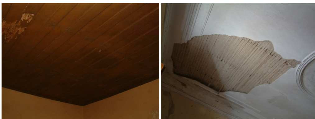
Figura 33. Teto de «saia camisa» e teto de fasquiado com argamassa de gesso.
