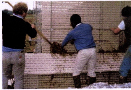
FIG. III.47 - BÉLGICA – Leuven – Aplicação da terra palha com cofragem perfurada, segundo técnicas actuais. 18
