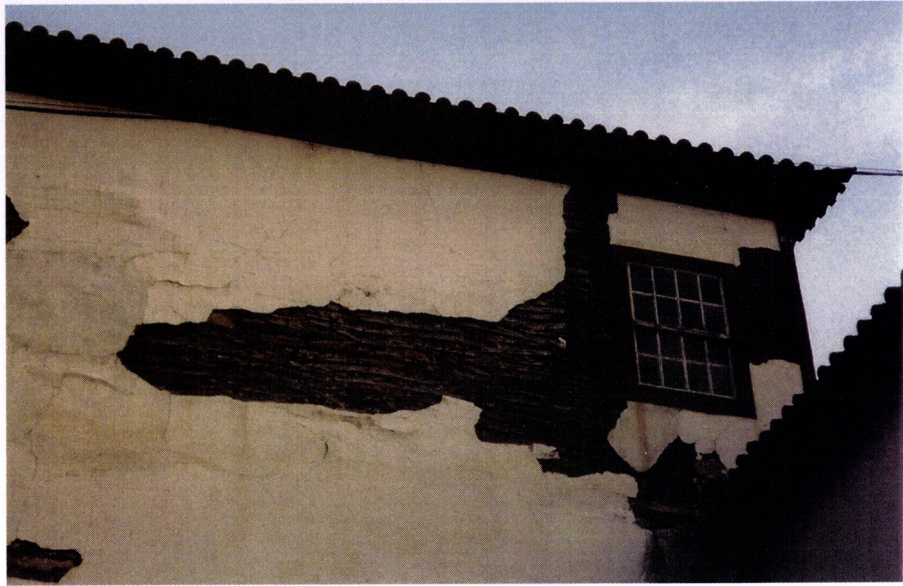
FIG. III.108 - PORTUGAL – Peso da Régua – Casa em avançado estado de ruína. As paredes exteriores são compostas por terra sobre engradado. Provavelmente a proximidade do Rio Douro proporcionou a existência de solos apropriados para este tipo de construção.
