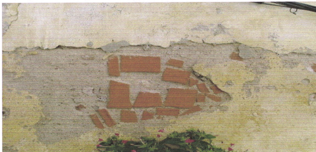
8.5 – Reboco desagregado. Rua das Beatas. (foto do autor)
