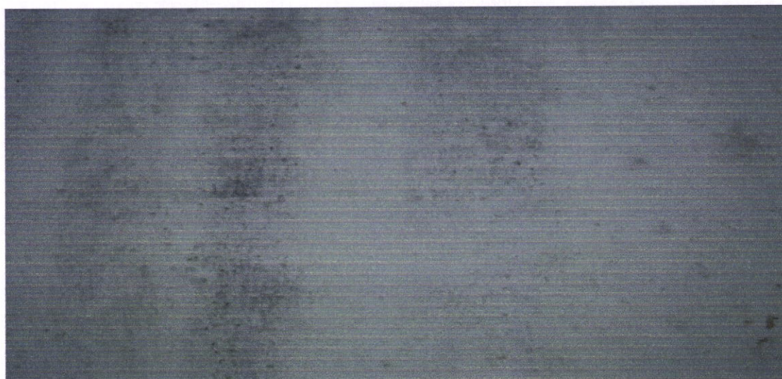
8.13 – Sujidade. Rua das Beatas. (foto do autor)
