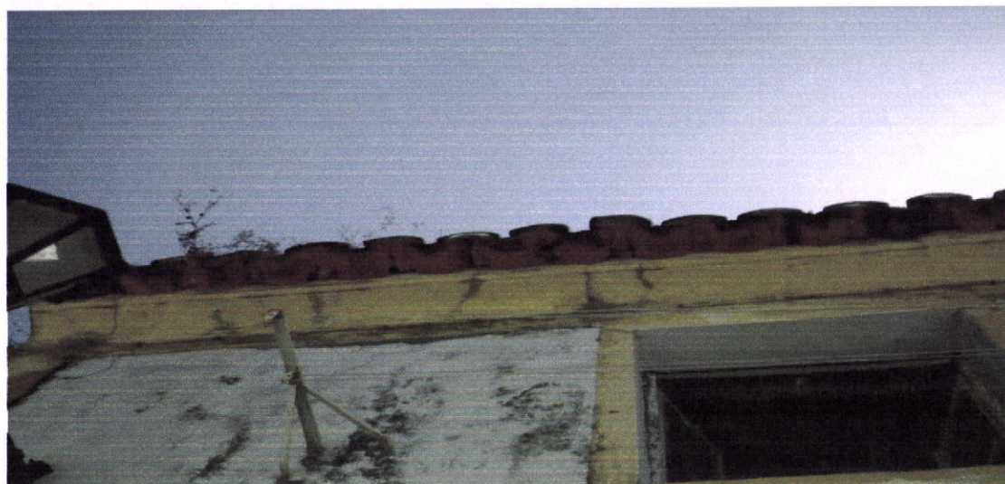
8.10 – Manchas de humidade. Rua das Beatas. (foto do autor)
