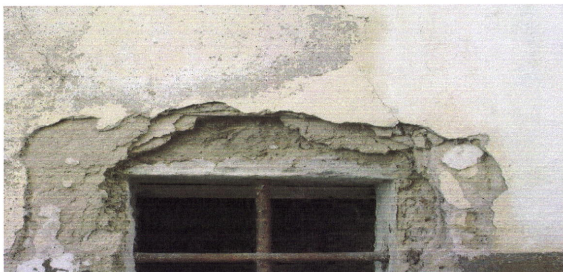
8.6 – Reboco desagregado. Rua das Beatas. (foto do autor)
