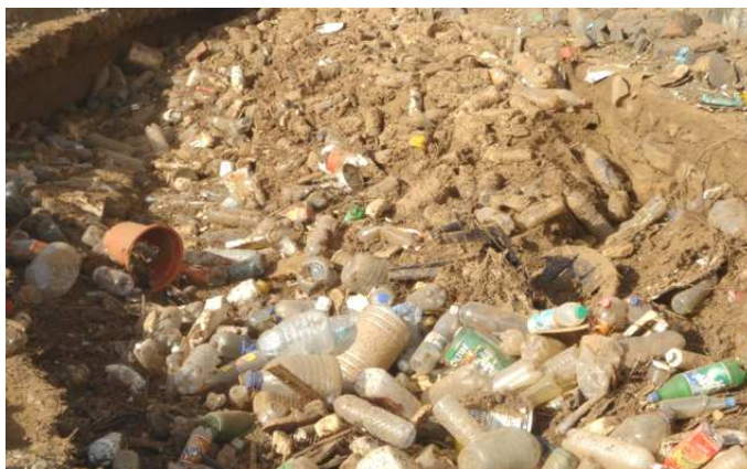
Imagem nº 4 – Vala de drenagem obstruída por lixo e lama
