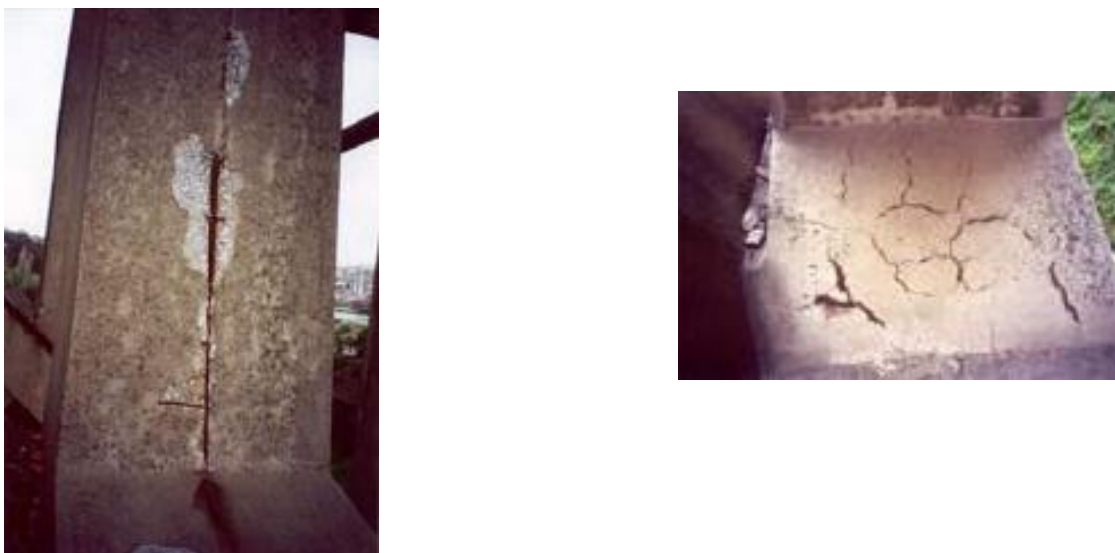
Fig.3 – Estruturas de betão alteradas por reacções de expansão [13].
