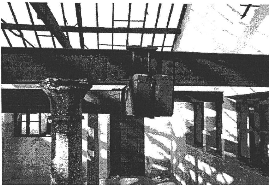
Anexo 9 – Ruínas do antigo Matadouro Municipal. Vestígios da utilização do ferro em funções de suporte e cobertura.
