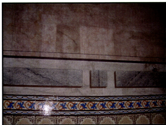
Fig. 184 – Igreja do Carmo. Viana do Castelo. Abertura de janelas de limpeza para testar biocidas.
