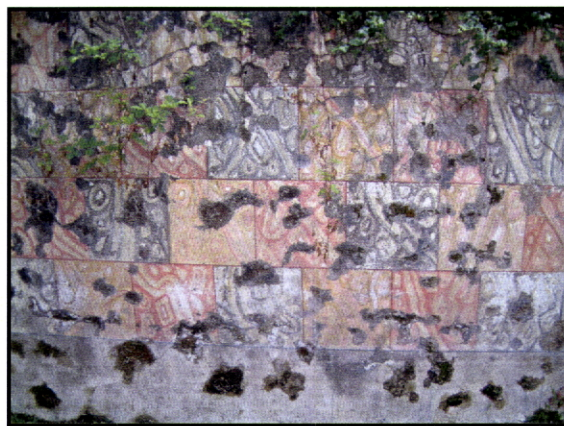
Fig. 88– Celorico de Basto. Arnóia. Fonte da Casa do Telhoa. Pormenor do paramento lateral direito, onde se vê a imitação de marmoreado em dois tons, e a forte colonização biológica de líquenes e fungos.
