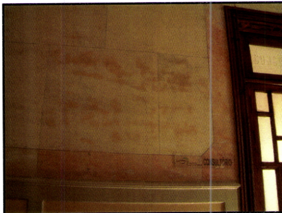
Fig. 173 – Hospital Termal das Taipas. Átrio revestido em marmoreados simulados em stucco-lustro . É evidente o desaparecimento da cera de acabamento.
