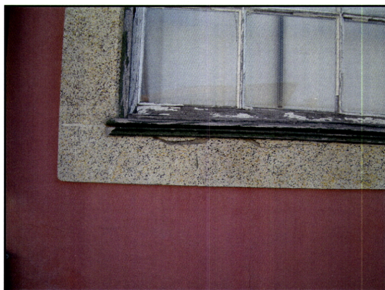
Fig. 131 – Casa da Praça. Celorico de Basto. Pormenor de fissuração do reboco fino de cimento, aplicado sobre o granito para fingir granito através de pintura.
