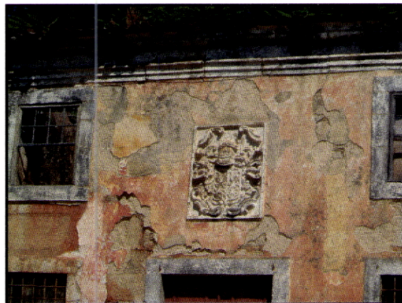
Fig. 103 – Celorico de Basto. Casa do brasão. Pormenor de um brasão em estuque de cal e gesso em exterior. As várias camadas cromáticas do edifício estão em destaque, devido à desagregação dos rebocos de base.
