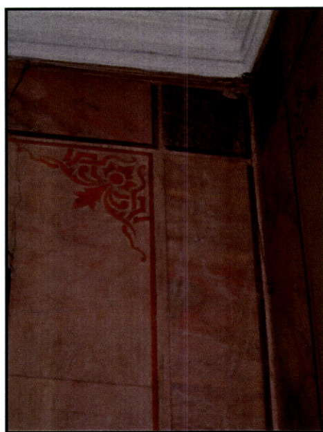
Fig. 177 – Casa Branco de Faria. Vizela. Paramento em marmoreado pintado a fresco. A moldura foi pintada a seco. É visível a acumulação de sujidade.
