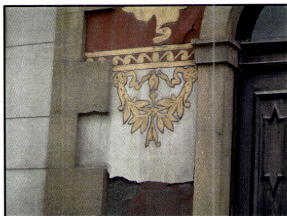
Fig. 121 – Teatro-Cinema de Fafe. Pormenor da parte inferior da fachada pintada em tom mais claro. A camada cromática está em destaque.
