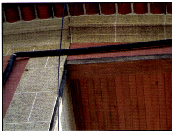
Fig.129 – Casa da Praça. Celorico de Basto. Exemplo da situação descrita na imagem anterior. O fingimento foi aplicado sobre granito verdadeiro. No cunhal testemunha-se o material verdadeiro e o fingimento de granito sobre granito. As juntas da pedra estão simuladas por tinta branca, de péssimo efeito estético.
