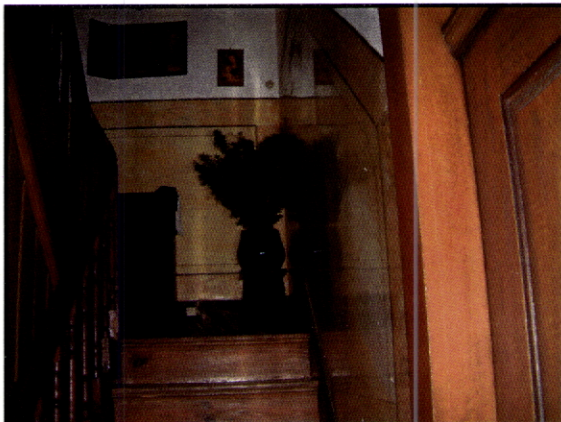
Fig. 166 – Casa do Pinheiro. Guimarães. Parede em stucco-lustro da escada de acesso à cave. O brilho deixa antever um acabamento semelhante ao do piso superior.
