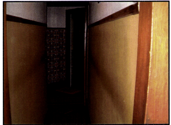
Fig. 167 – Casa do Pinheiro. Guimarães. O desaparecimento das técnicas e dos artistas, impede os proprietários de recuperarem as suas casas. Pormenor de uma parede em stucco-lustro que foi pintada por não haver quem a possa recuperar.
