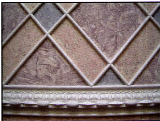
Fig. 137 – Palacete Abrunhosa. Viana do Castelo. Gessos embutidos em técnica de stucco-marmo . A moldura e respectivos frisos foram aplicados posteriormente.
