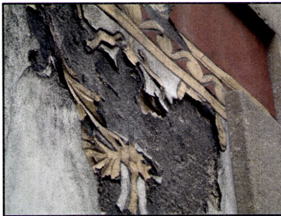
Fig. 120 – Teatro-Cinema de Fafe. Toda a fachada foi revestida com uma capa de asfalto com o objectivo de impermeabilizar. Sobre o alcatrão, foram aplicadas duas camadas pictóricas que simulam esgrafitos.
