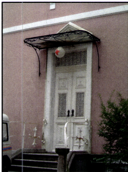
Fig. 108 - Chalé Arte Nova. Porto. Pormenor do frontão em estuque, da estrutura de cobertura em ferro e vidro.
