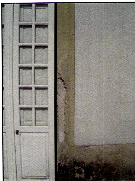
Fig. 96 - Casa de Eiró de Baixo. Mondim de Basto. Pormenor de uma ombreira fingida em desagregação. É evidente o ataque biológico no embasamento.
