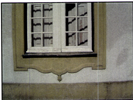
Fig. 94 - Casa de Eiró de Baixo. Mondim de Basto. Pormenores dos elementos arquitectónicos fingidos em argamassa moldada (arco, balcão e mísulas da varanda)
