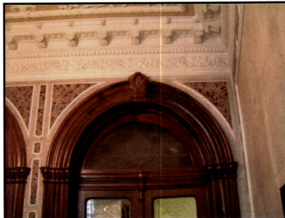
Fig. 139 – Palacete Abrunhosa. Viana do Castelo. Aspecto das molduras decorativas em gessos embutidos do hall da entrada.
