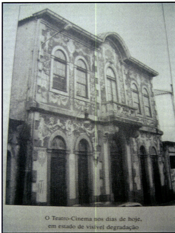
Fig. 126 - Teatro-Cinema de Fafe em 1997. (A F. Coimbra, ob. cit. , p. 168). As duas fotografias permitem perceber que as partes inferiores da fachada foram pintadas com uma tinta mais clara.
