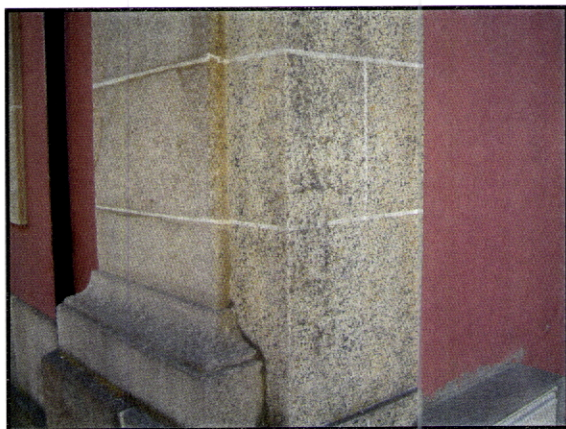
Fig. 128 - Casa da Praça. Celorico de Basto. Exemplo de uma má recuperação, onde se pode ver uma tentativa de simular granito de grão fino. Recorreu-se a uma técnica de salpico de duas tintas de tons diferentes, preta e amarela, tentando imitar os minerais da rocha, "dripping".
