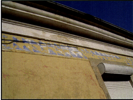
Fig. 79– Paredes de Coura. Piorada. Fingido de azulejo de meia-cara em reboco de cal. Sobre o fingido foi aplicada uma tinta plástica.
