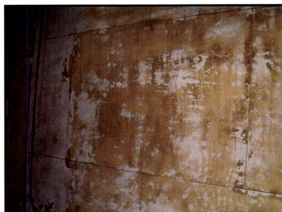
Fig. 155 – Casa de Jogueiros. Felgueiras. Revestimento de stucco-lustro em mau estado. É nítido o acabamento a cera, agora em destacamento.
