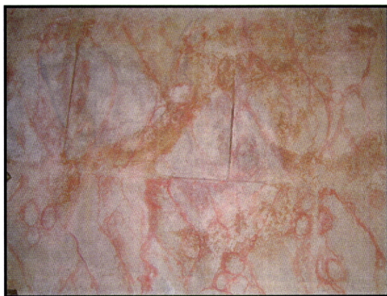
Fig. 175 – Paço de Sezim. Guimarães. Paramento exibindo uma pintura de marmoreado sobre estuque de cal e gesso. Exemplo de um restauro de má qualidade.
