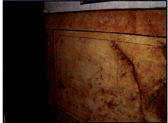
Fig. 165 – Casa do Pinheiro. Guimarães. Pormenor do retoque de uma fissura do estuque. Exemplo de uma moldura simples executada a pincel.
