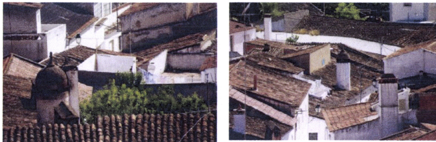
Fig. 4. 244, Fig. 4. 245 - Moura, Bairro da Mouraria, coberturas em telha de canudo (fotos da autora)
