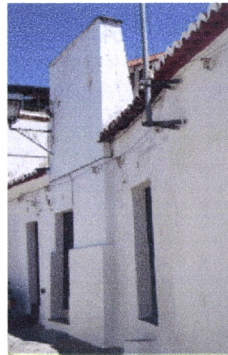
Fig. 4.260 – Moura, Bairro da Mouraria, casa com chaminé de ressalto deturpada (fotos da autora)
