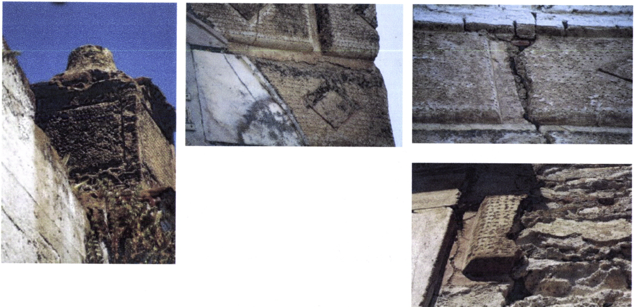
Fig. 4.181, Fig. 4.182, Fig. 4.183 e Fig. 4.184 – Moura, Convento de Nossa Sr.ª da Assunção do Castelo, parede da entrada principal, patologias bem evidentes em franca evolução (fotos da autora)
