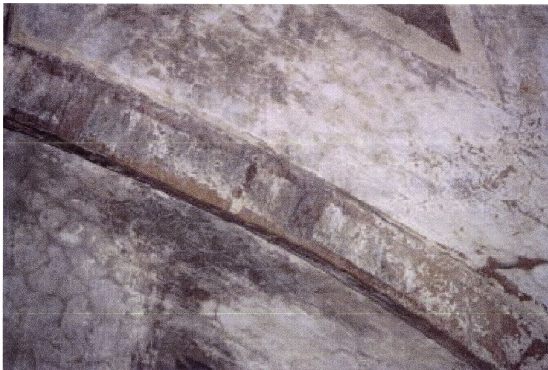
Fig. 4.202 - Moura, Convento de Nossa Sr.ª da Assunção do Castelo, visualização de algumas patologias (foto da autora)
