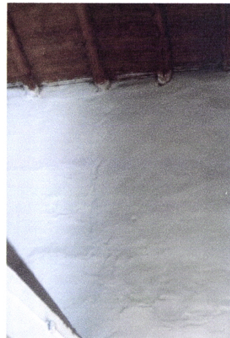
Fig. 4. 243 – Moura, Bairro da Mouraria, casas com forro de caniço (foto da autora)
