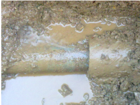
Figura 17-Conduto Fibrocimento com união simplex (em desgaste de anéis de borracha) na rede distr. de S.Bento Cortiço
