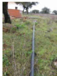
14 – Tubagem PEAD da Captação Techocas RAI
