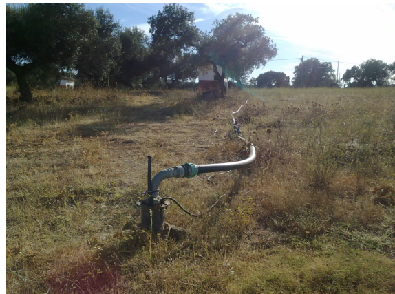
Figura 14 - captação RA1 (techocas)
