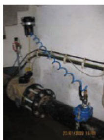
26 – Novo Contador e Telemetria numa Captação de Techocas
