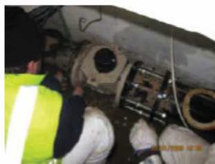
22 – Montagem de Contador e Telemetria numa Captação de Techocas
