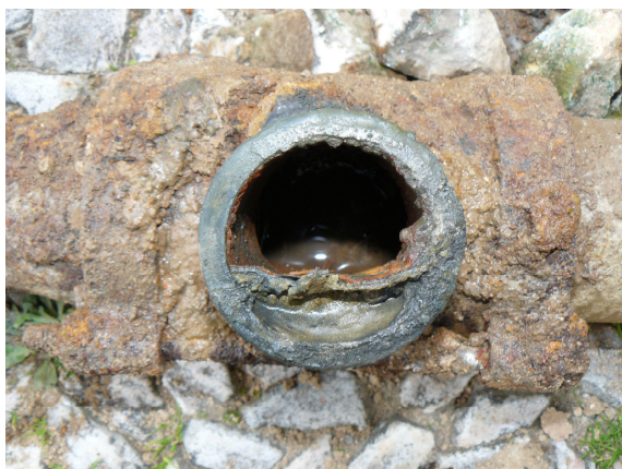
Figura 24-Pormenor 2 do interior da válvula
