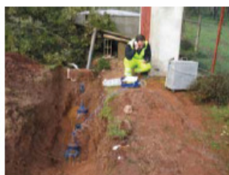
28 – Instalação de Telemetria no Contador Totalizador do Cabaço e PS8
