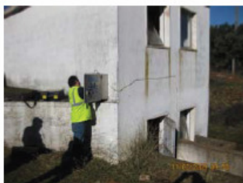
31 – Instalação de Telemetria na Saída gravítica para Veiros
