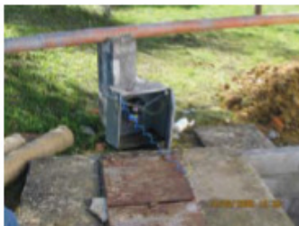
34 – Telemetria na Captação do Álamo
