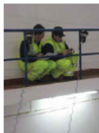
29 – Instalação de Telemetria na EE das Techocas para Arcos e Estremoz
