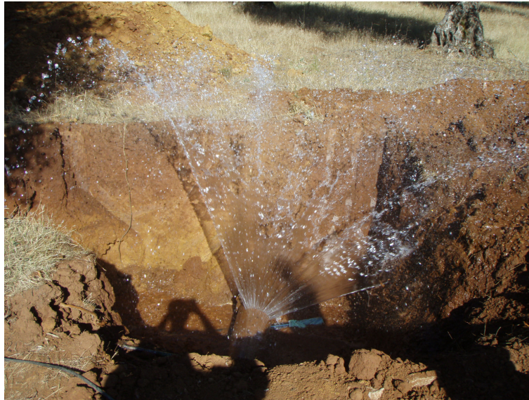
Figura 16-Reparação de rotura na conduta de Arcos Ø100mm (desgaste de uniões) – Agosto 2009
