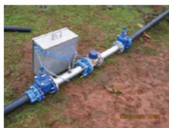
25 – Novo Contador e Telemetria na Captação Techocas – RA1
