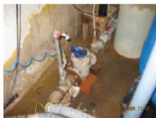
32 – Novo Contador na Captação da Pedreira
