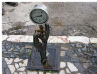
13 – Manómetro de Registo em boca de rega na Cidade de Estremoz
