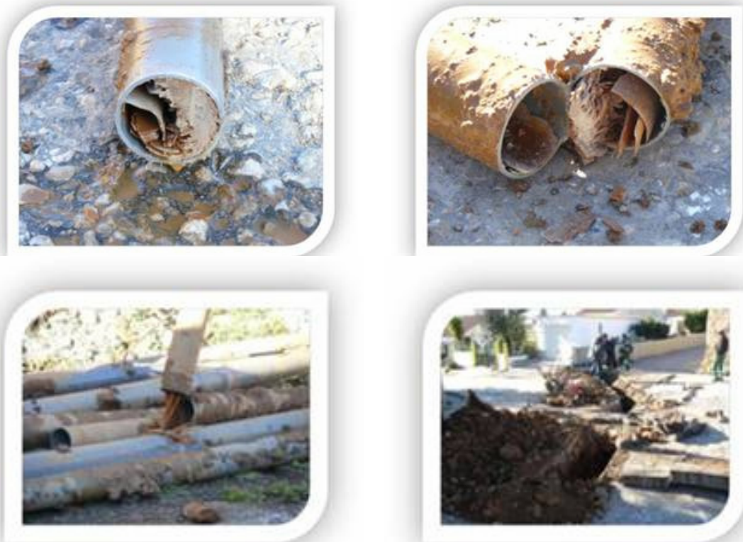
Figura 21- Exemplos de incrustação em condutas de PVC (Rede de Distribuição da Glória)
