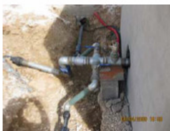
38 – Saídas não monitorizadas a jusante do Contador do Furo do Campo da Bola
