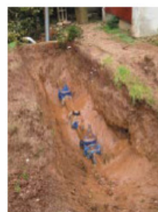
27 – Novo Contador Totalizador das Captações Cabaço e PS8
