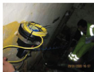
30 – Telemetria na Captação da Pedreira
