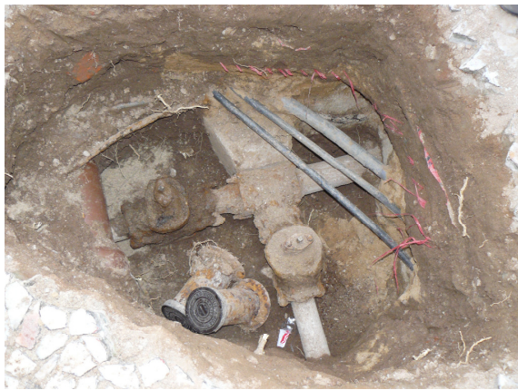
Figura 22-Válvulas no nó da Av. 25 de Abril com o Rossio, Estremoz (válvulas degradadas por efeito da corrosão)
