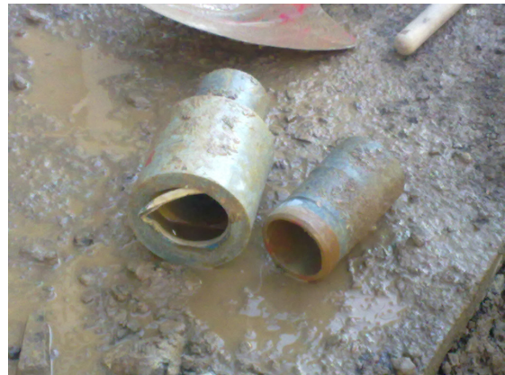
Figura 18-Conduto Fibrocimento com união simplex (em desgaste de anéis de borracha) na rede distr. de S.Bento Cortiço
