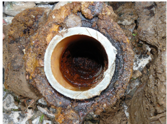
Figura 23-Pormenor 1 do interior da válvula
