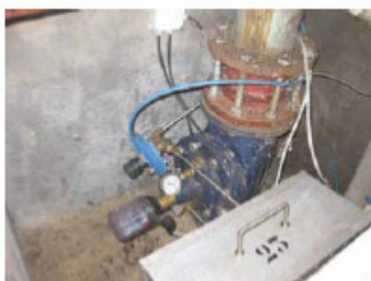
19 – Registador de Pressão no Reserv. Calçada da Frandina
