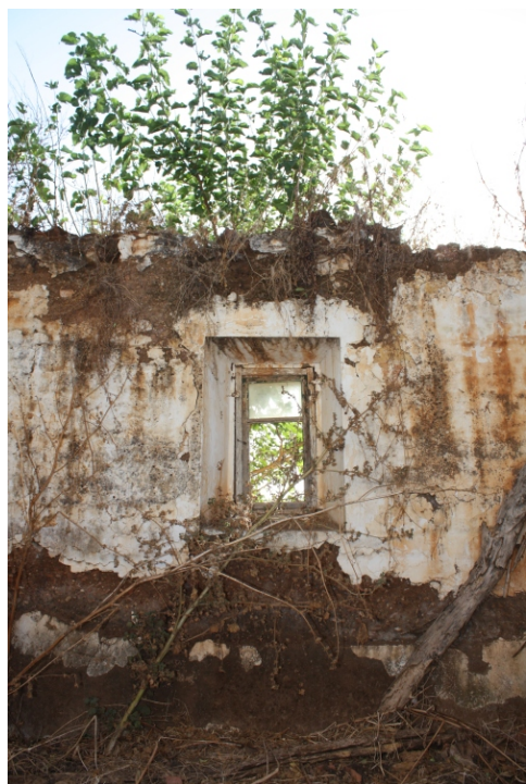
Interior do único quarto, cuja cobertura colapsou.
