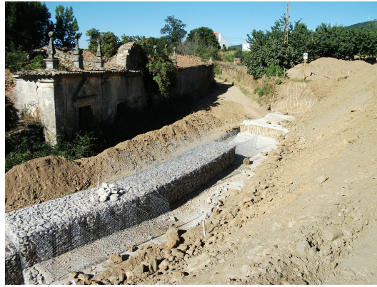
Figura 31 - Construção do muro de gabião junto à quinta de S. Caetano em alternativa ao talude existente.
