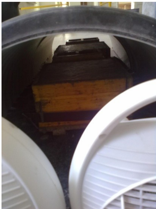
Figura 40 – Sistema de aquecimento e ventilação em funcionamento
