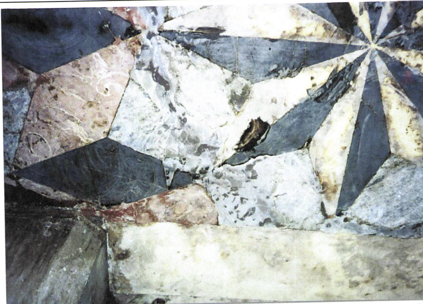
Il. 44 – Basílica da Conceição da Praia (Salvador, Bahia): Reintegração desastrosa do piso de lioz português, com resina de poliéster, sem qualquer respeito às juntas e à cor do material.
