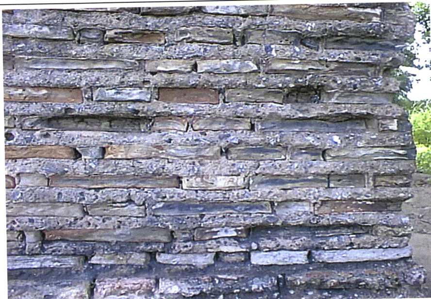
Il. 47 – Porto Seguro (Bahia, Brasil): Alvenaria de tijolos onde a argamassa de cal, saibro e areia, demonstra melhor resistência do que o material cerâmico, que apresenta sinais de má queima.
