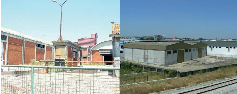
FIG. 7 - Exemplo de um espaço abandonado em processo avançado de degradação.
